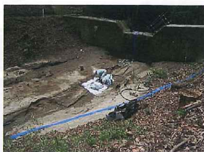
台風後の排水装置設置前
